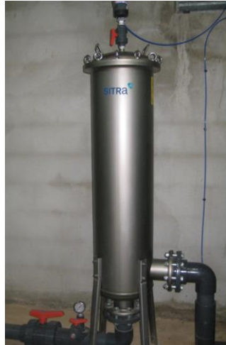
Figura 8. Filtros de cartucho en ETAP Supoi-8.
