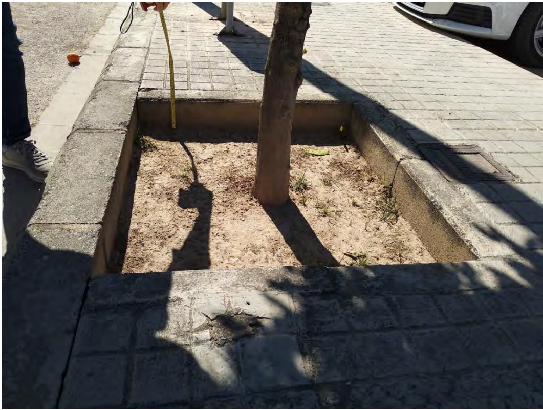
C/ Corts Valencianes. Desnivel considerable del interior del alcorque respecto a la acera
