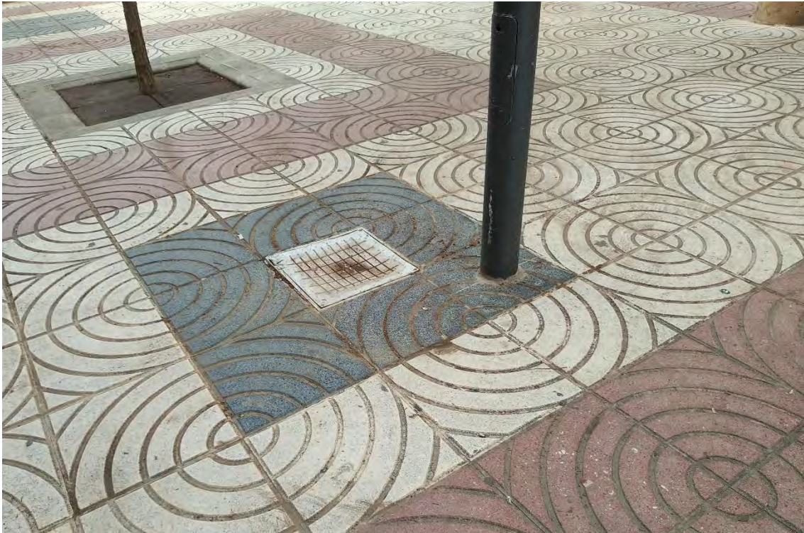
Plaça de la Llar. Registro con tapa de PVC deteriorada y alcorque protegido con loseta de caucho.
