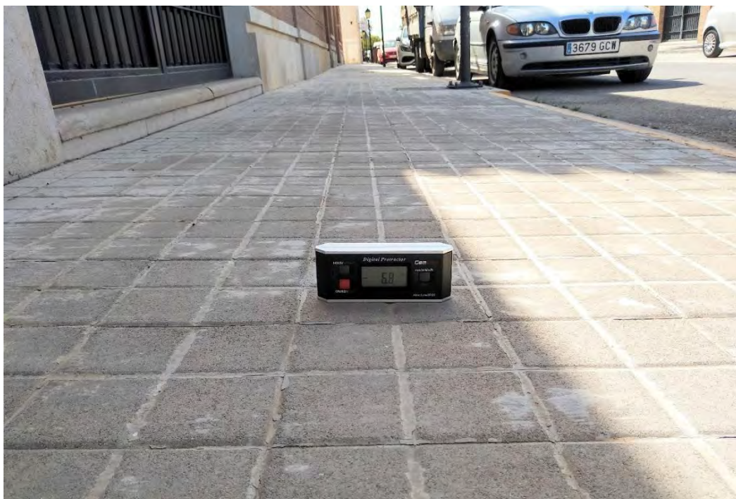
C/ Parafanga. Pendiente transversal en acera muy superior al 2%.
