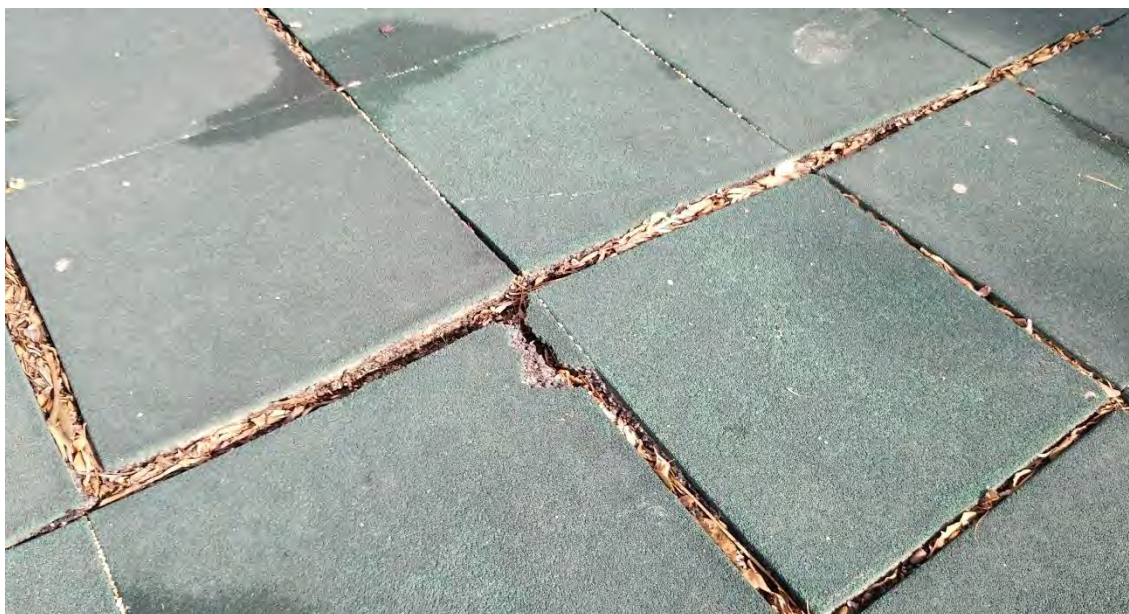
C/ Federica Montseny. Pavimento de caucho en parque infantil deteriorado.
