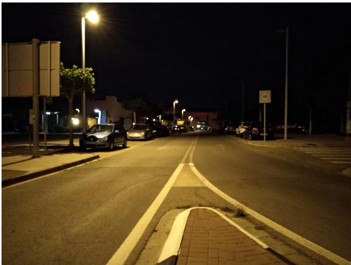
C/ Ernest Lluch Martí desde rotonda. Se observa un nivel de iluminación deficiente en la acera izquierda y muy deficiente en la derecha al no estar operativas las farolas.
