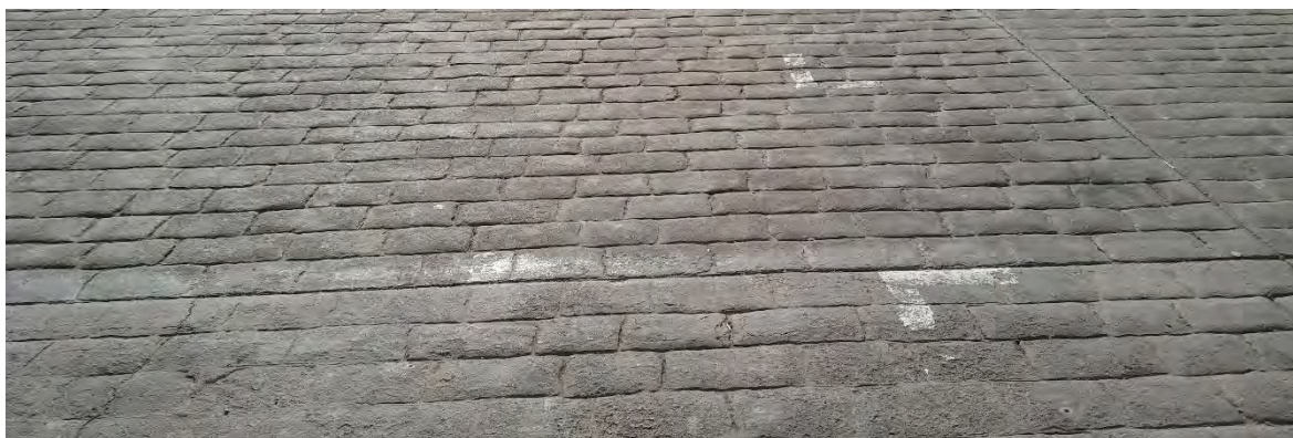
Plaça del Poble. Pavimento de hormigón impreso simulando adoquín (gran cantidad de juntas simuladas).
