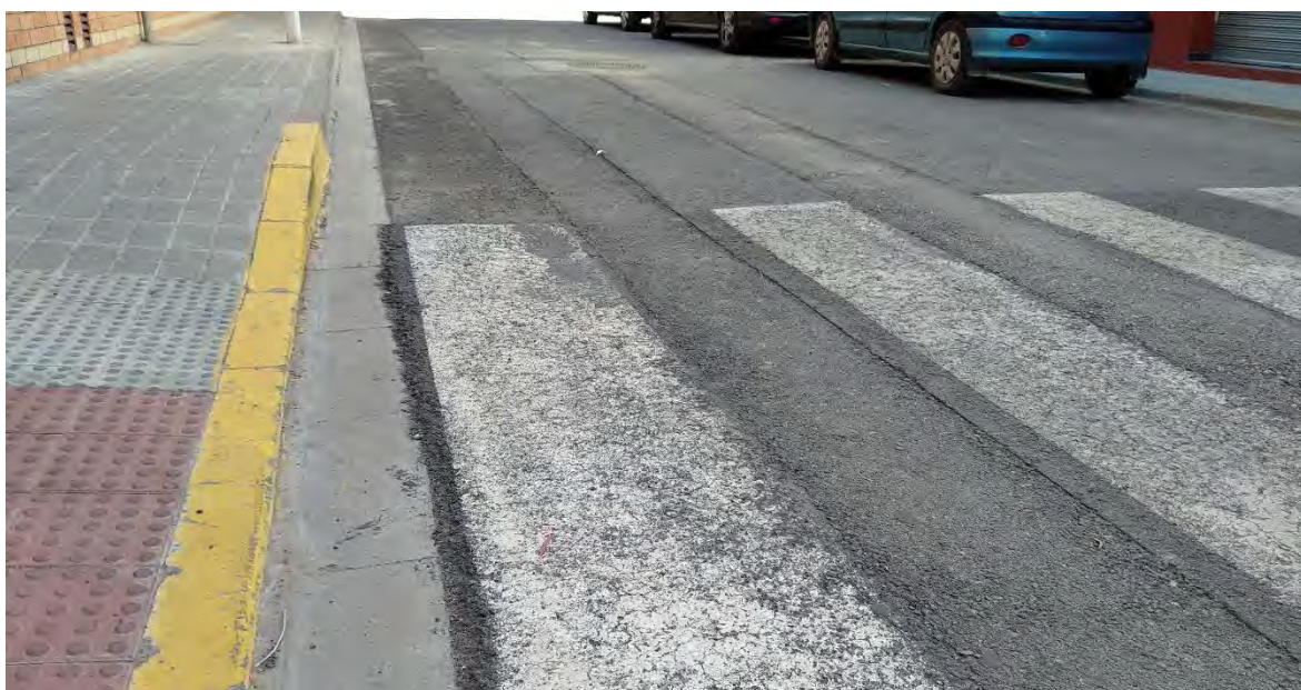
C/ Pintor Vicente Lluch-C/ Els Ports. Resalte asfalto-rigola.
