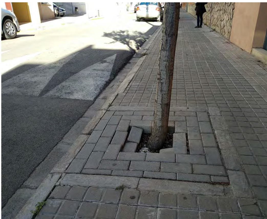
C/ Pintor Vicente Lluch, 37. Protección de alcorques con adoquines deteriorada.
