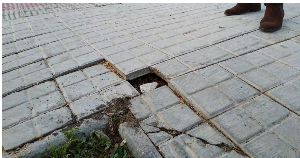
C/Federica Montseny cruce con C/ Ernest Lluch Martí. Pavimento levantado y deteriorado.
