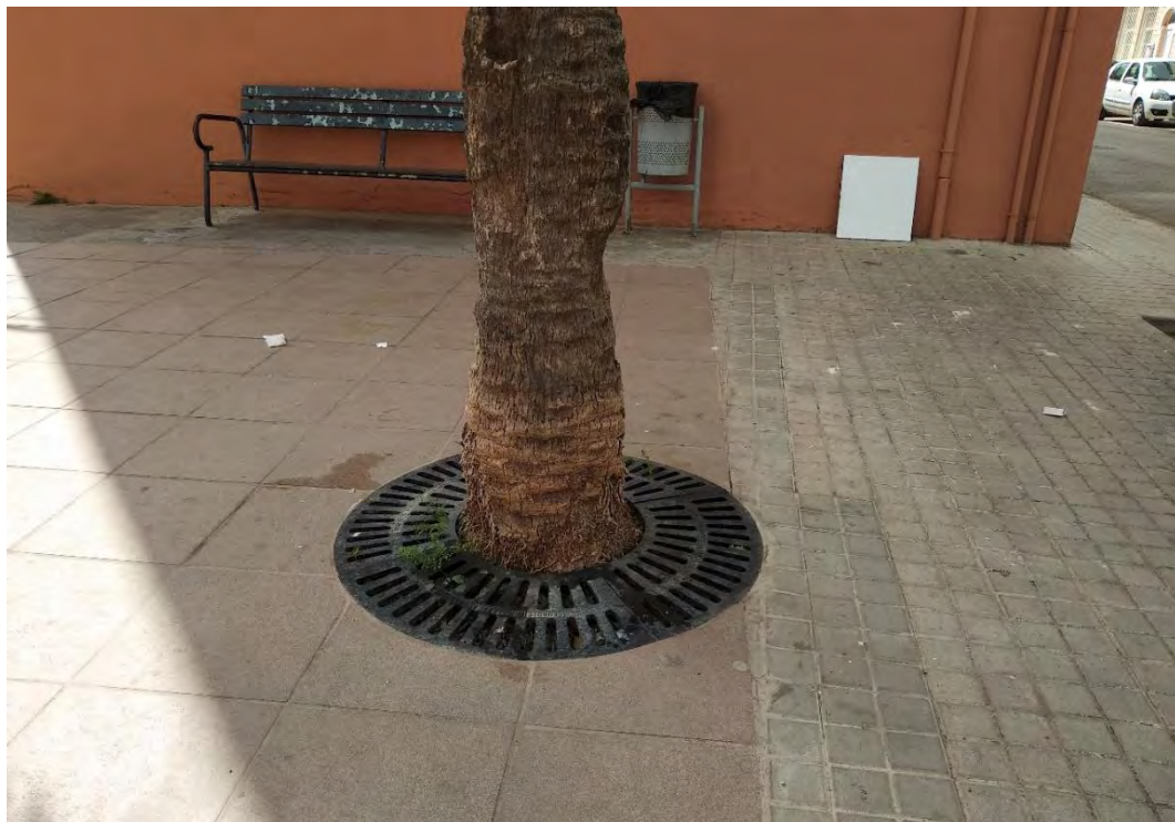
Plaça de la Llar esquina C/ Verge del Pilar. Alcorque protegido con rejilla de abertura excesiva
