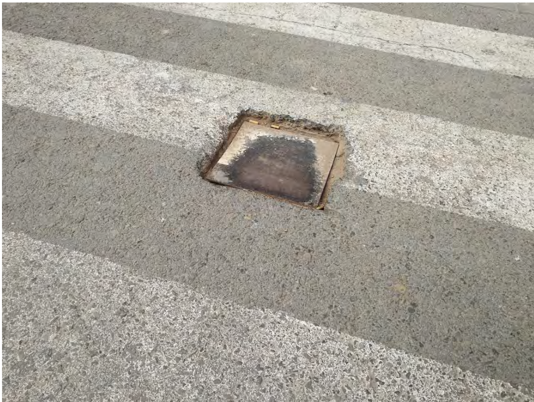
C/ Verge del Pilar, 33. Registro no enrasado en paso de peatones.
