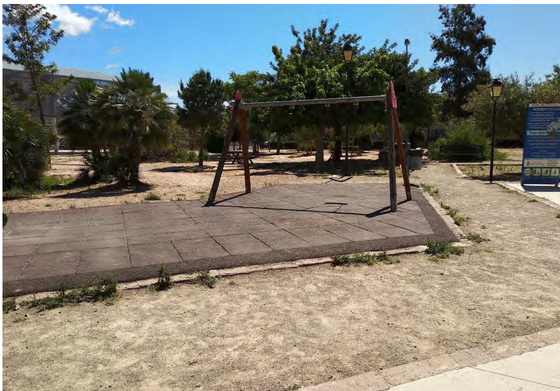
Parque de los Paellers. El acceso al columpio presenta un resalte.
