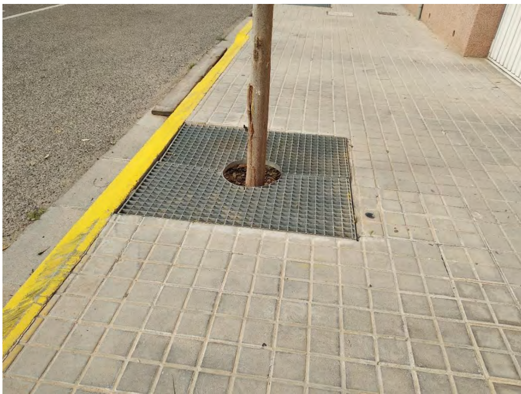
C/ Federica Montseny. Alcorque cuya rejilla de protección está deformada.
