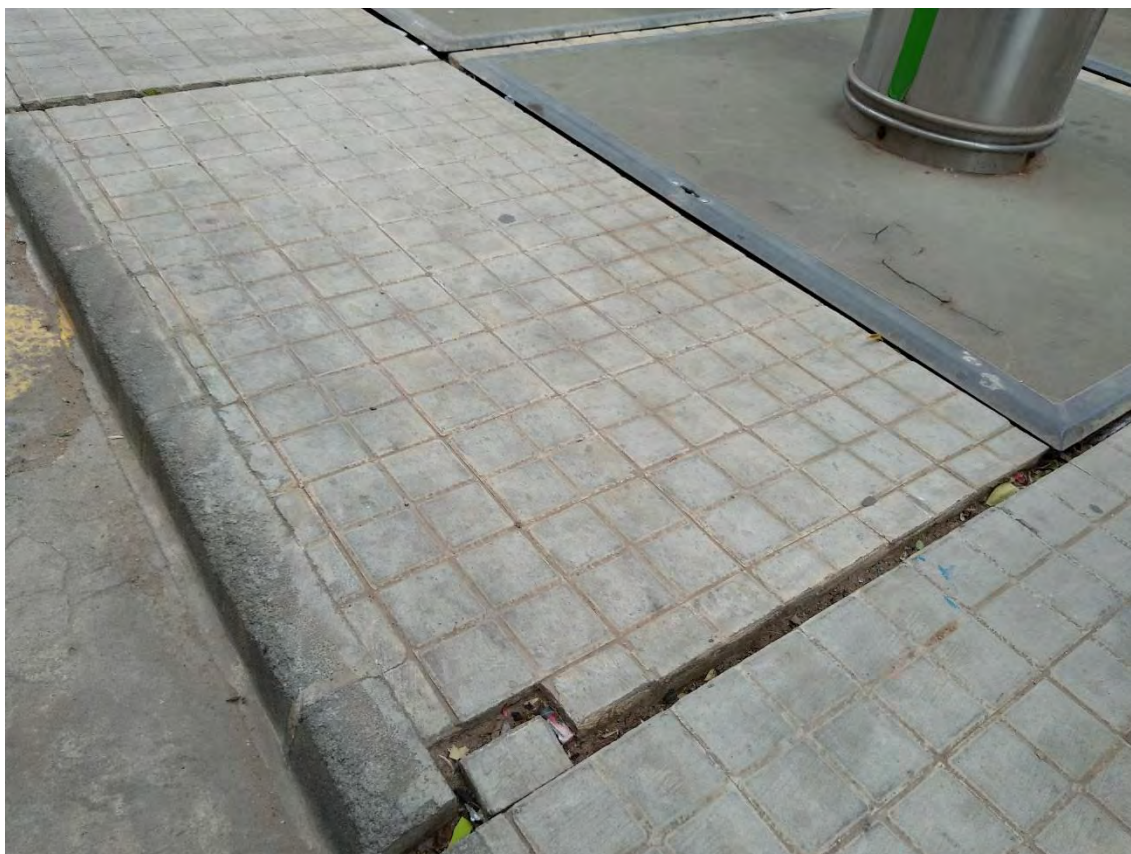
Plaça dels Oficis-C/ Llauradors. Hay juntas de gran anchura sin sellar en el acerado circundante a los contenedores enterrados. Posible riesgo de tropiezos y caídas.
