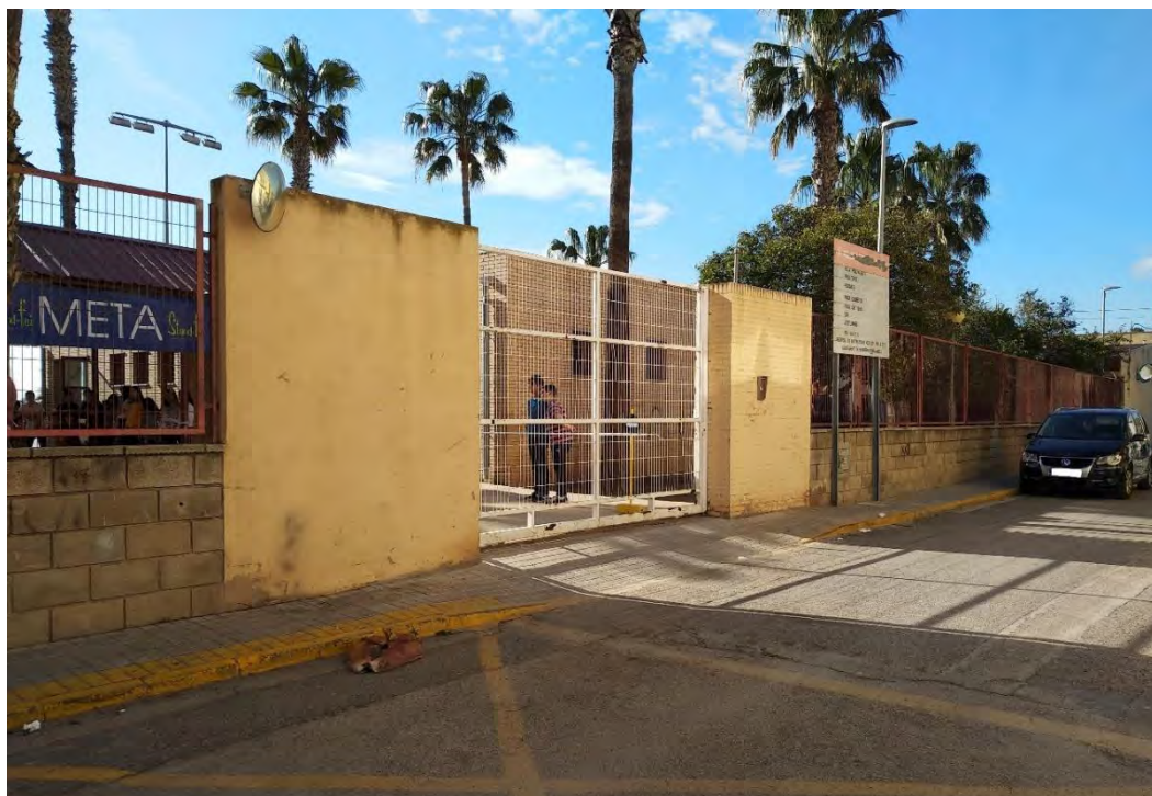
C/ Macarella. Polideportivo. Salida de vehículos con pendiente transversal muy elevada en acera.
