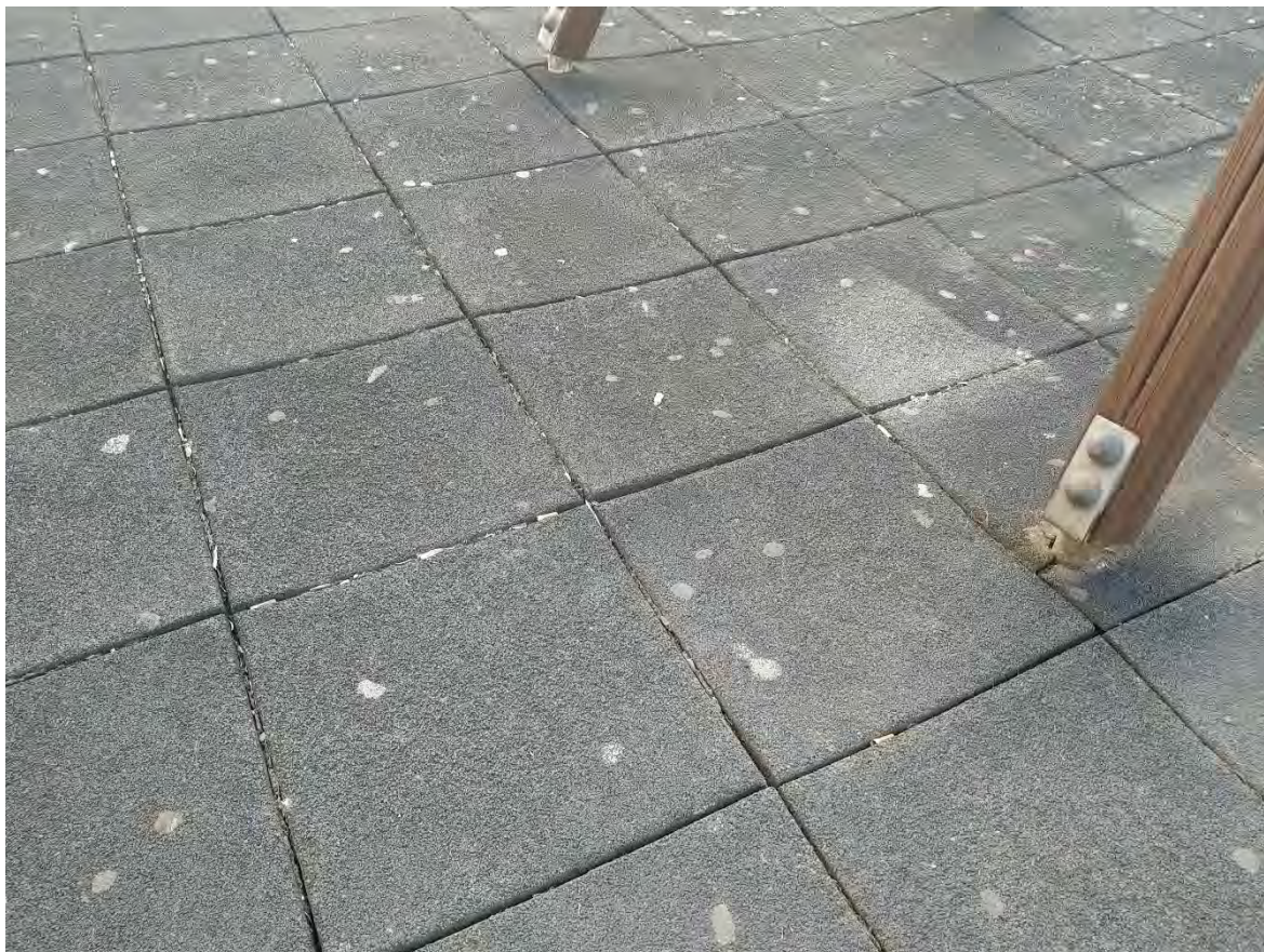
Zona de juegos en C/ Sant Vicent. Losetas de caucho que empiezan a mostrar signos de deterioro.
