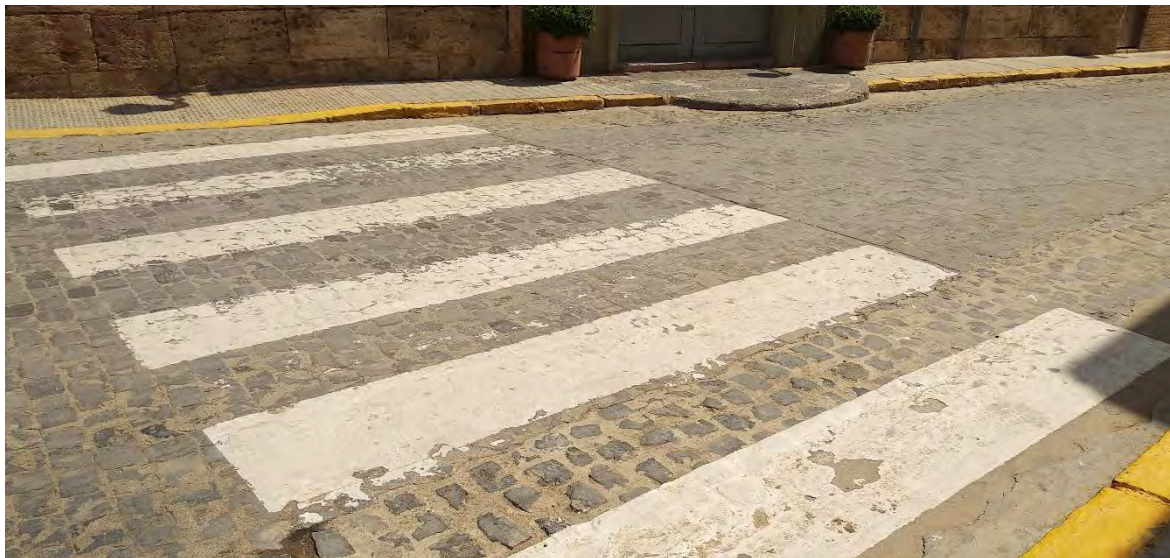
Plaça de l'Església - C/ Major. Paso de peatones ejecutado con adoquín. Juntas anchas y piezas irregulares.
