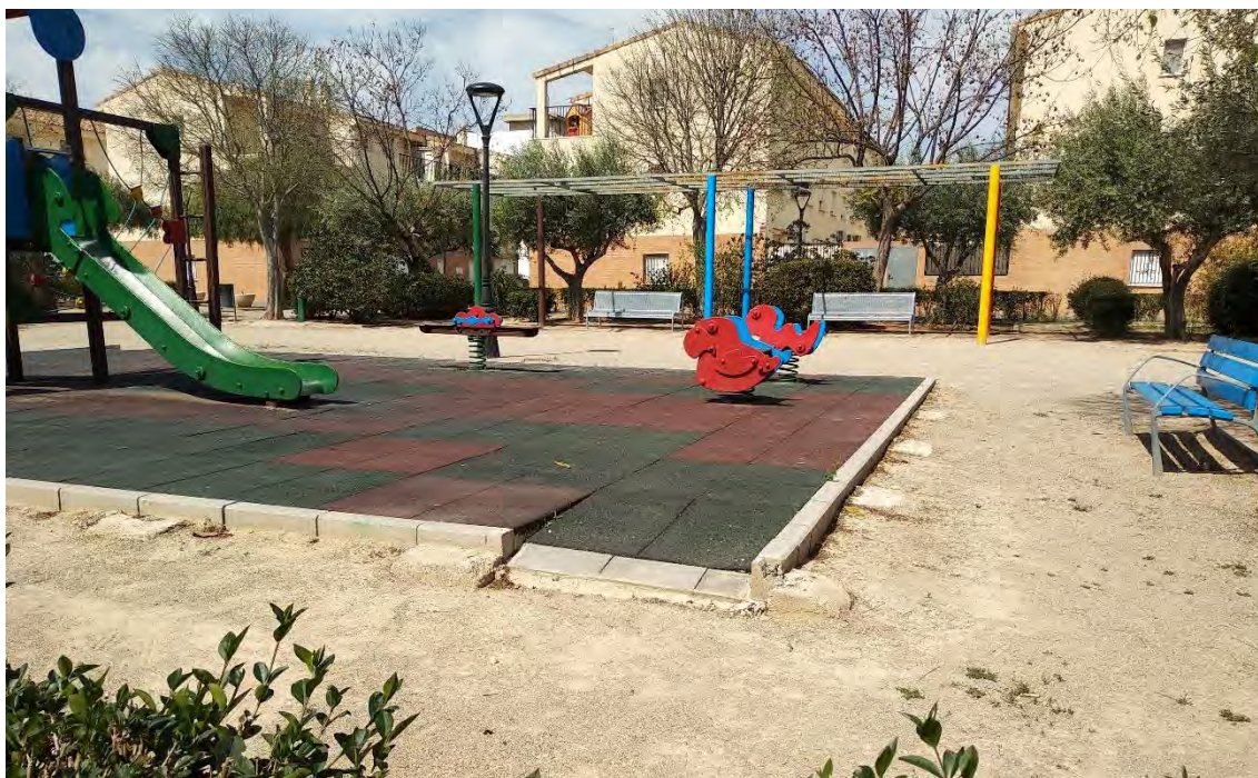
Plaça dels Oficis. La pieza de bordillo en el inicio de rampa de acceso a la zona de juegos presenta resalte.
