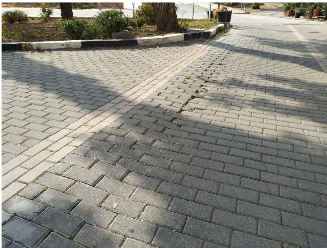
Plaça del Sol. Pavimento de adoquines deteriorado.
