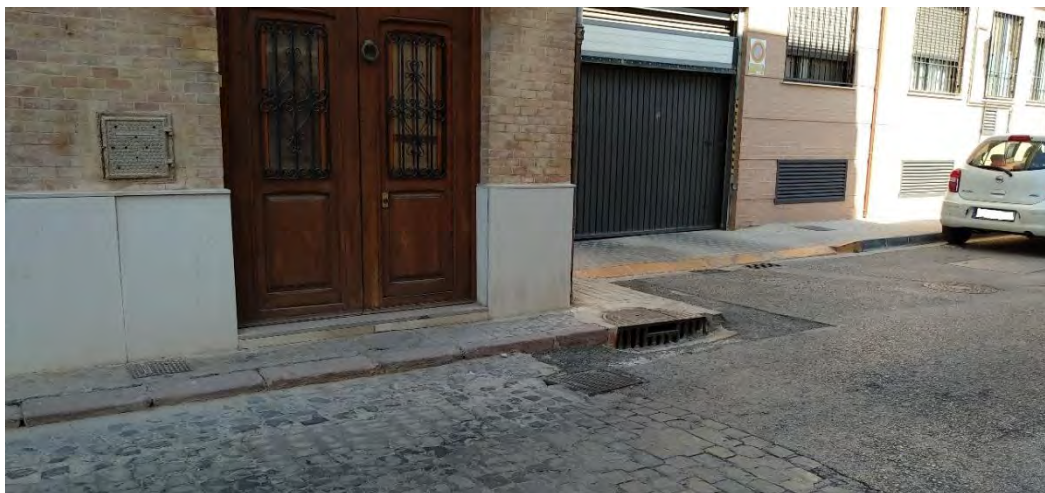
Plaça Església, 3. Anchura libre de acera insuficiente para el paso de una persona.
