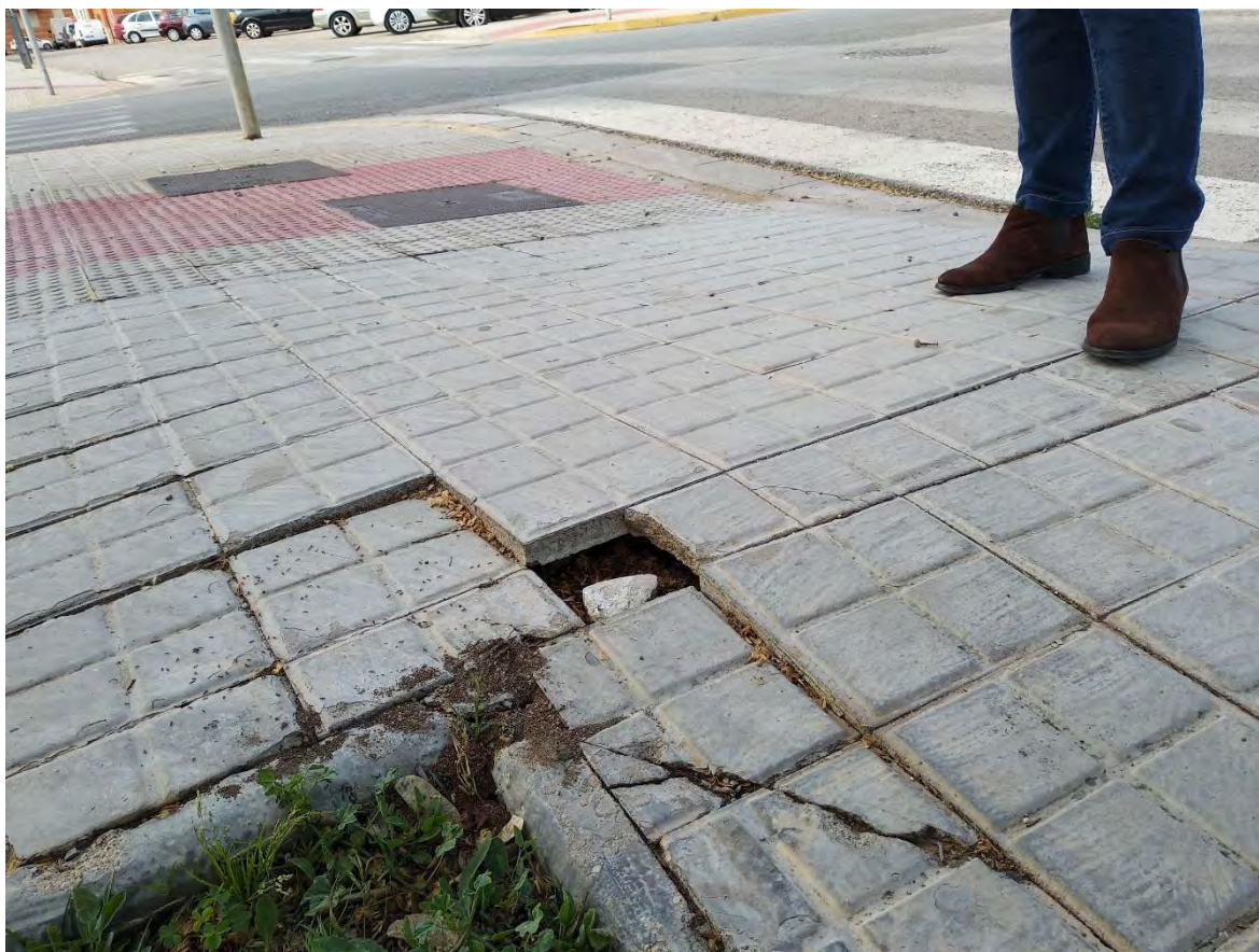
Calle Federica Montseny. Pavimento de baldosa hidráulica deteriorado.
