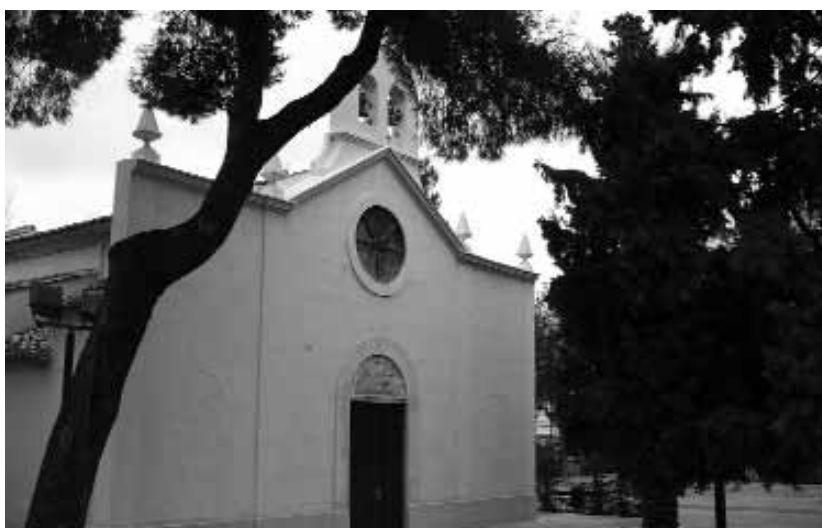
Fachada acabada a falta de colocar el marco de la vidriera que tapa el rosetón.
