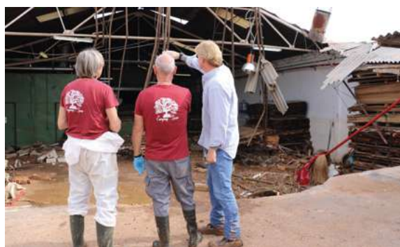
Muchas empresas sufren daños estructurales
