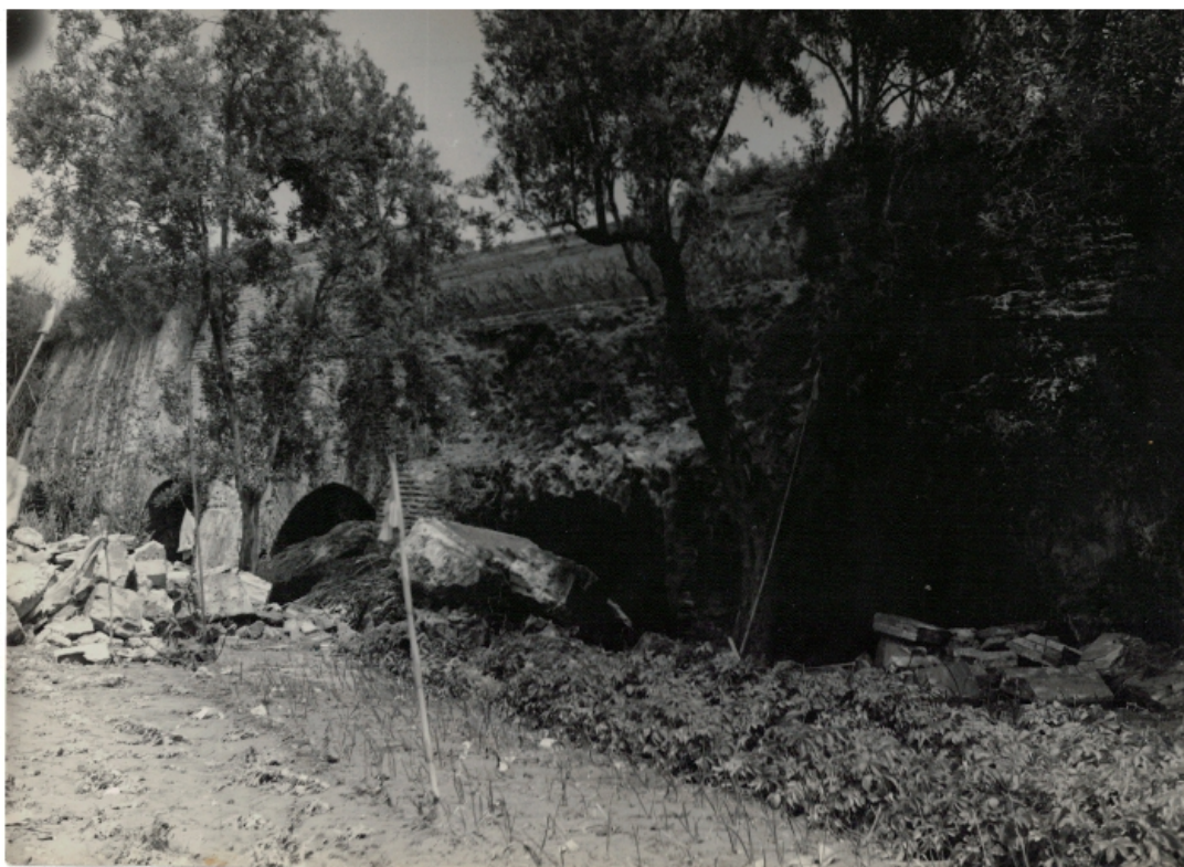
Fig. 13. Rotura del acueducto del Arquets de Manises el 26 de abril de 1966.
