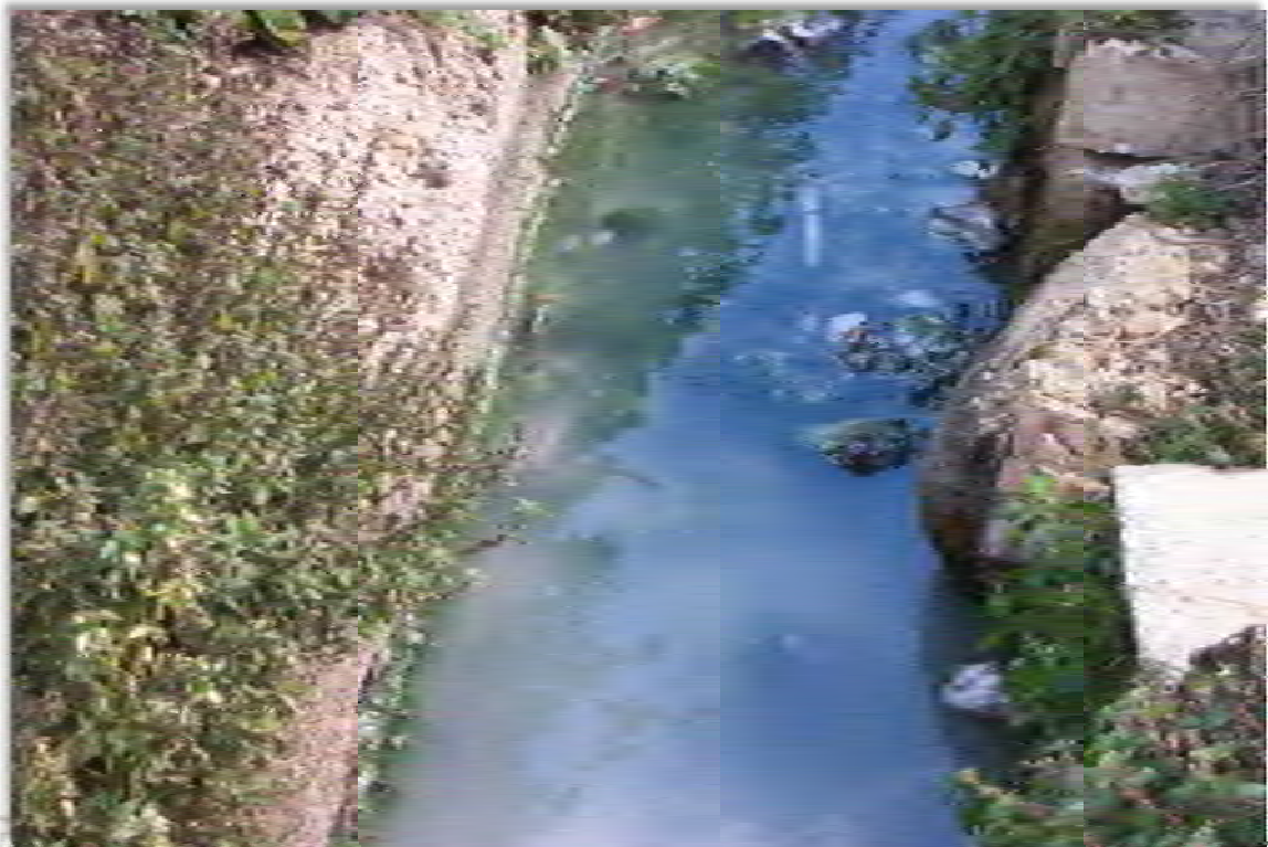
II-lustració 76: . Sèquia de rec en mal estat. Font: Foto José Andrés Sanchis
